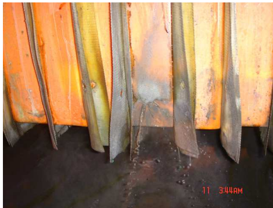
Vista detallada borde lateral externo con filtración en operación. Grietas en placas de filtración de UHMWPE
