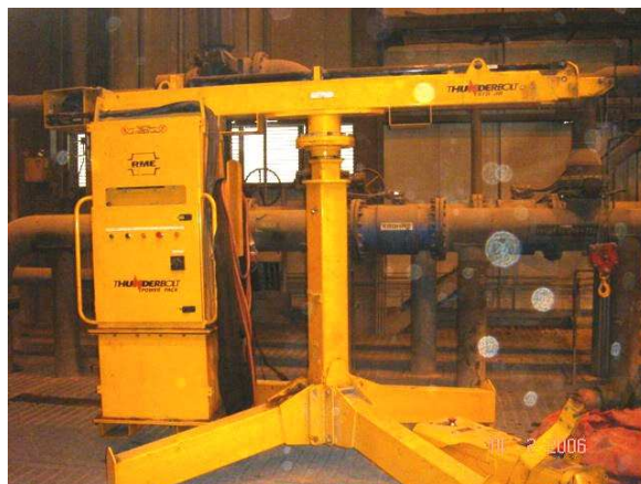
Estructura de soporte del bota-pernos (Collahuasi)
