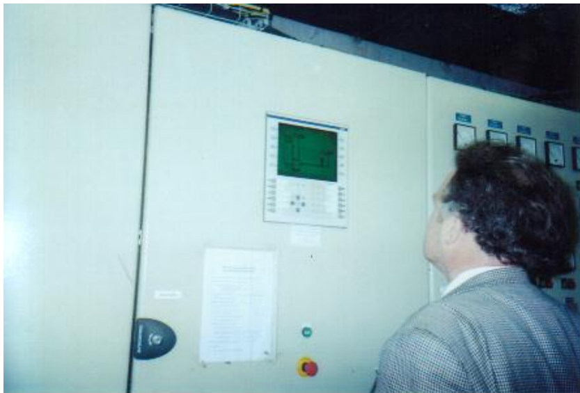
Fig.5: sistema de monitoreo de planta de tratamiento de aguas servidas en Lons-le-Saunier – Francia.
