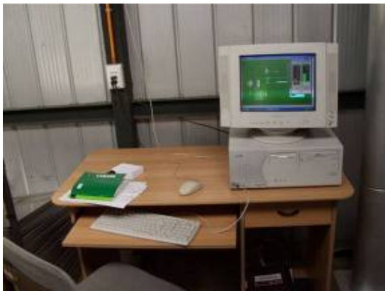
Sistema de Control de Procesos
